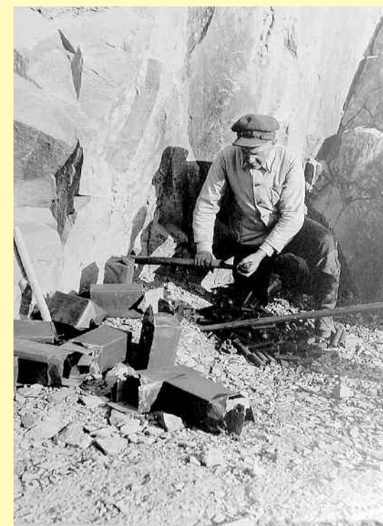
Nach der Rodung des Waldes und dem Abräumen des Waldbodens bis auf den Hartsteinfels konnte mit den Vorbereitungen zum Sprengen begonnen werden.
